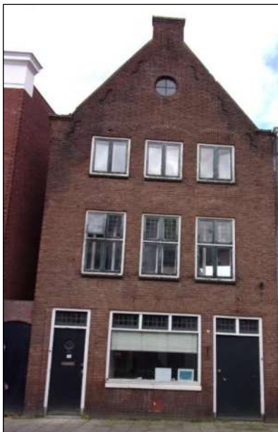
Afb. 2: De gevel van de voormalige drukkerij op Hinthamereinde 66 verkeert in verwaarloosde staat. Het uithangbord is verdwenen. Achter de gevel vinden thans (maart 2023) sloopwerkzaamheden plaats. Het drukkerijgedeelte ligt geheel in puin.
